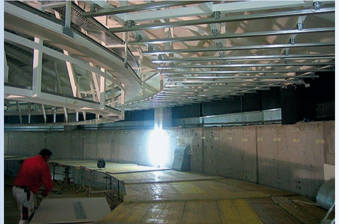
Strahlenförmig aus dem Deckenzentrum heraus angeordneter Metallprofilrost der Protektor Profil GmbH. Jedes einzelne CD-Profil wurde im Grundriss eingezeichnet und vermasst.
