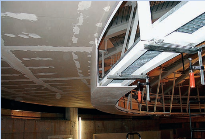
Montage der Formteile, welche einen Ring bilden mit einem Innenradius von 9 m. Versetzt wurden insgesamt 56 m, d.h. 24 Formteile von je 2,30 m Länge.
